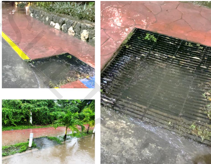
Ilustración 39. Pozo de absorción pluvial.
